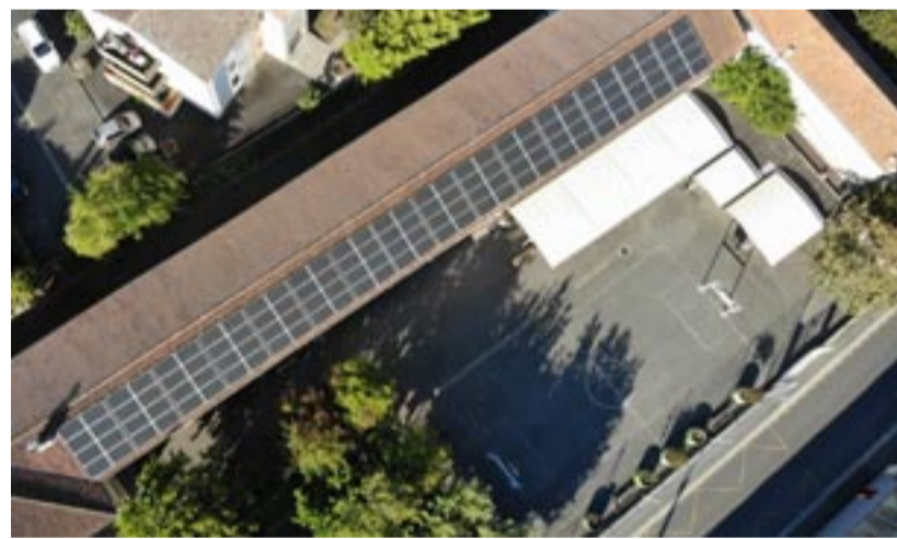
Des panneaux solaires sur le toit de l'école Marcel Sembat à Bègles.
